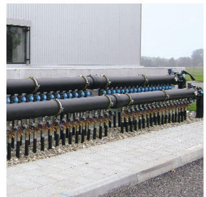
Collettore geotermico di grandi dimensioni
