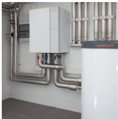
Unità idronica e bollitore ACS nel seminterrato
