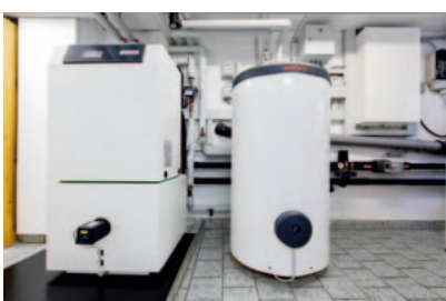
Il nuovo sistema a pompa di calore
